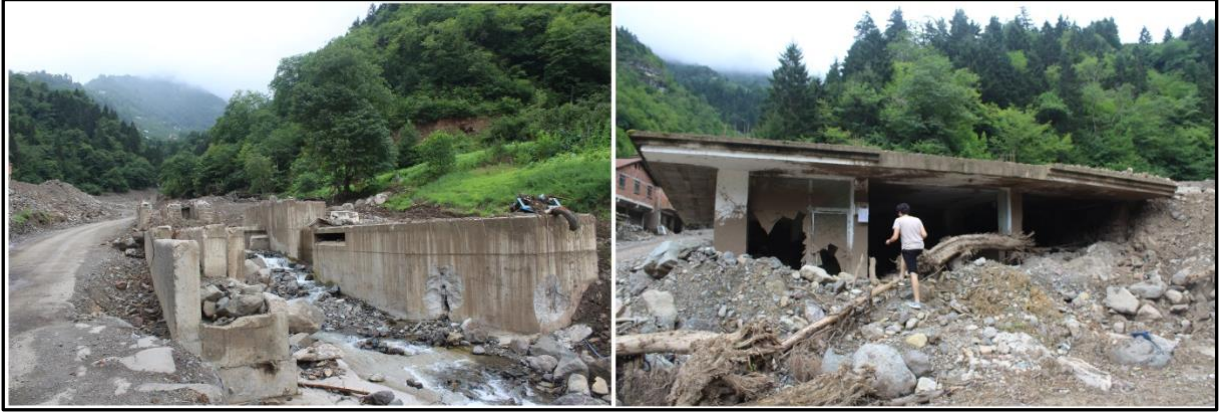
Şekil 12. Sel taşkında Çamlıktepe Mahallesi'nde yapılar zarar görmüştür.
